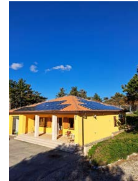
Slika 5.7 Nova solarna elektrana KMS-a Rijeka
